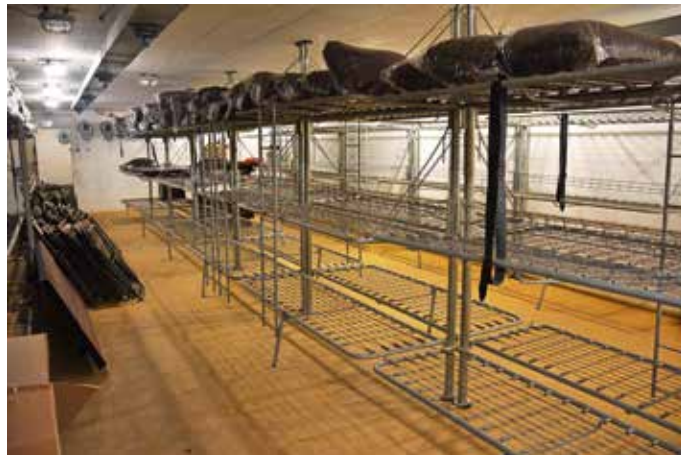
Javno zaklonišče med bloki v Medvodah ima dva prostora s posteljami, stranišča, strojnico ... / Foto: Maja Bertoncelj
