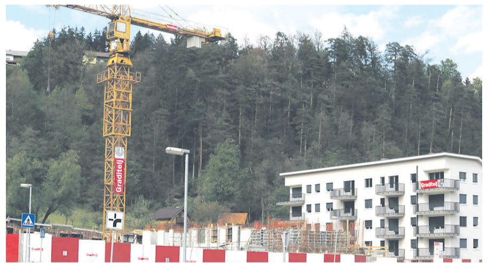
Oživila stanovanjska gradnja v Zgornji Savinjski dolini. Tako je bilo videti gradbišče že drugega mozirskega novega bloka pred zadnjimi prazniki.
