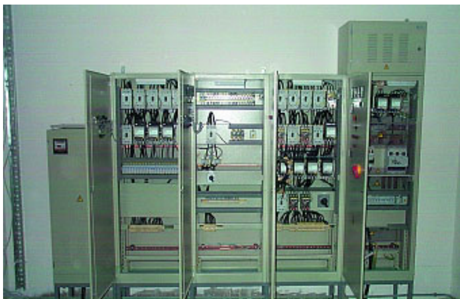
NN razdelilna plošča v transformatorski napajalni postaji Jasovnik ZAHOD v času montaže.
