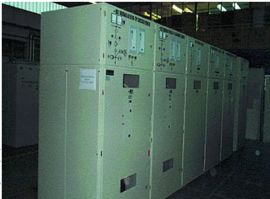
SN stikališče 20kV, 16kA za predor Ločica v času izdelave v proizvodnih prostorih IMP TEN-a.
