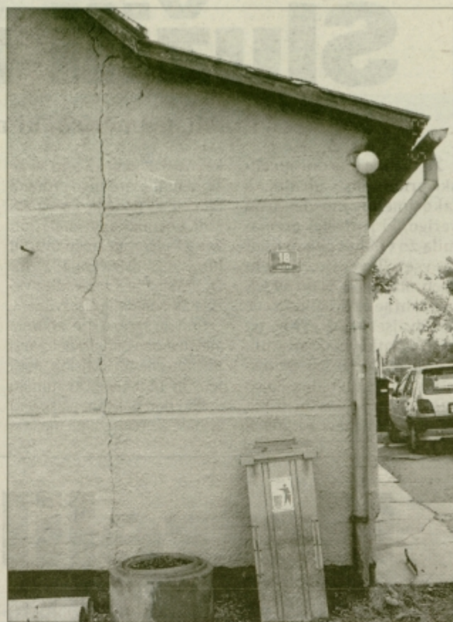
Hiša v Imenem 18, ki je bila med torkovim potresom med najbolj poškodovanimi.
