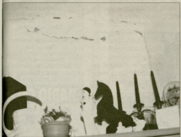
Poškodbe v notranjosti
