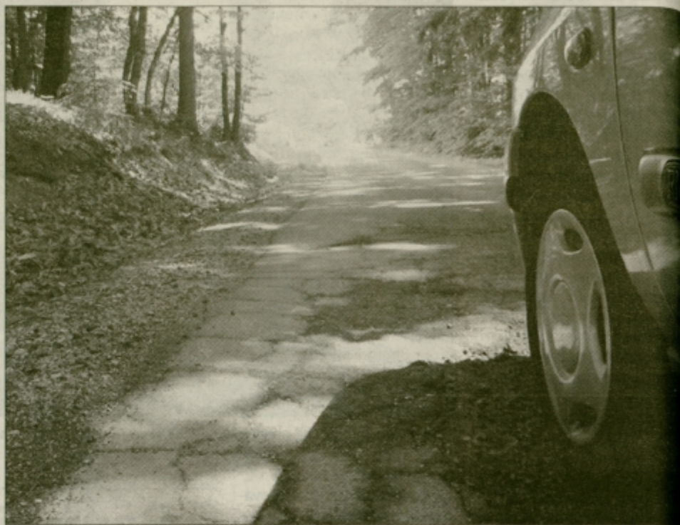
Zaradi plazovitega terena je na vozišču vse več udrtin.
