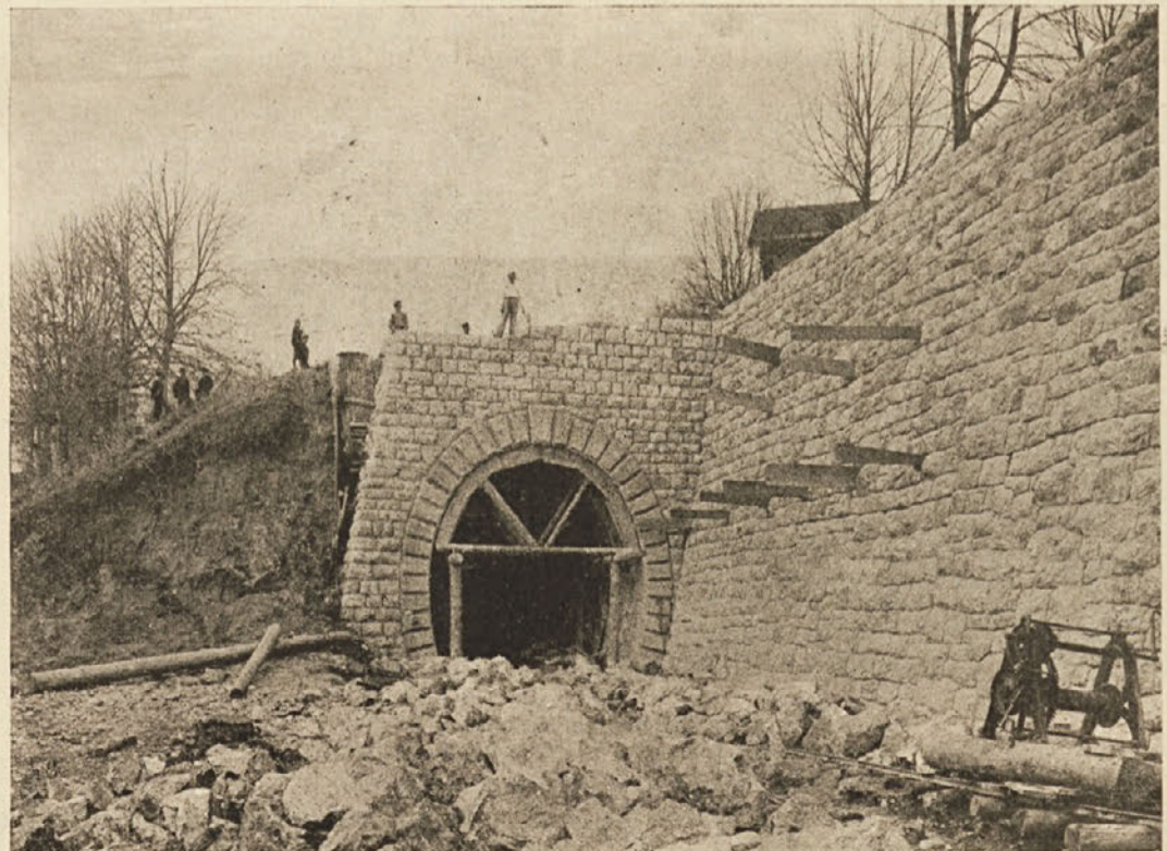
Zgradba belokranjske železnice: Izgotovljen obok in škarpa. (Po posebni fotografiji za Slov. Ilustr. Tednik.)
