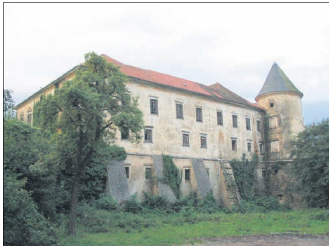
Občina Podčetrtek je pred leti poskrbela za novo streho propadajočega gradu Podčetrtek, kar ji omogoča zakonodaja. Vložen denar zahteva nazaj.
