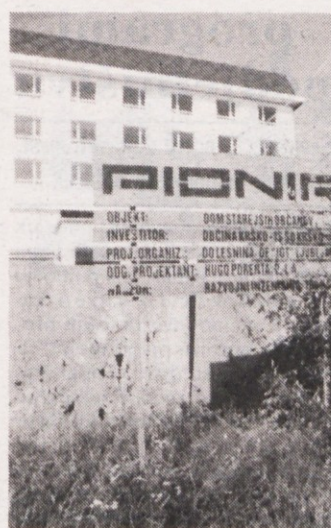
DOM UPOKOJENCEV KRŠKO - Objekta, ki so ga v Krškem začeli graditi kot dom starejših občanov, zdaj pa ga vse pogosteje imenujejo dom upokojenecv, tudi po več letih še niso zgradili do konca. Tabla pred zgradbo, posneta pred dnevi, sporoča, da pri tej gradnji najbrž več ne vedo, kdo pije in kdo plača. (Foto: L. M.)
