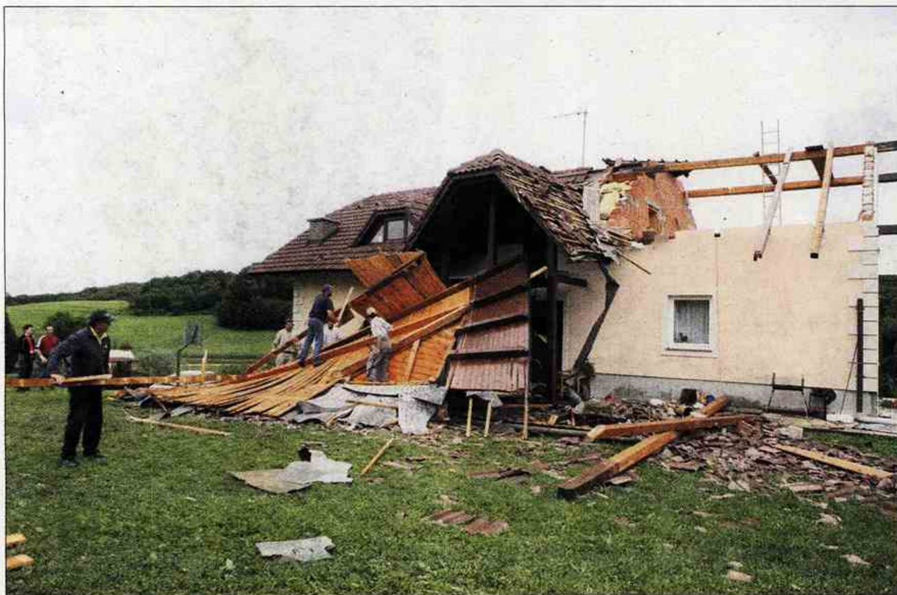
Grožljiv prizor izpred novejši hiše, ki je v trenutku ostala brez strehe. »Bili sva sami s hčerko. Tako glasno je pokalo, da sem mislila, da se podira cela hiša,« opisuje grožljive trenutke Silva Berk Bevc.
