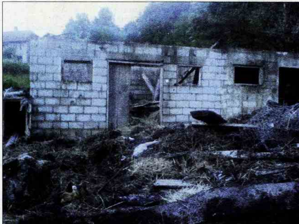
Vse, kar je ostalo od gospodarskega objekta ...
