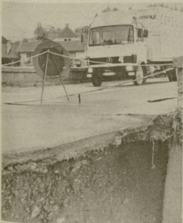
Voda je v Letušu spodkopala cesto in most.
