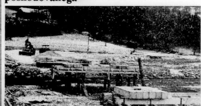
SLOVENJ GRADEC - Med zadnjim deževjem je narasla Mislinja spodkopala most na cesti Dravograd - Slovenj Gradec in zaradi tega je del ceste zaprt, promet pa so preusmerili po obvoznici. V teh dneh grade v neposredni bližini nov provizorični most za enosmerni promet (na sliki), ki ga bodo v kratkem izročili prometu. Prihodnjo leto pa bodo pričeli graditi nov most, saj po predvidevanju sanacija poškodovanega ne bo možna. (Foto: Bogo Cerin)
