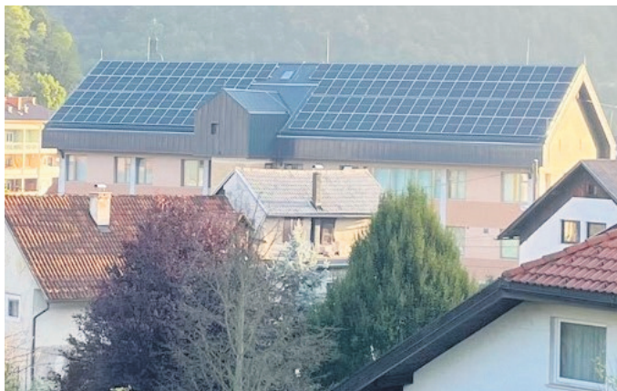
Sončna elektrarna na strehi ZD Radeče bo pokrila potrebe radeškega mestnega jedra po električni energiji. (Foto: Suncontract)
