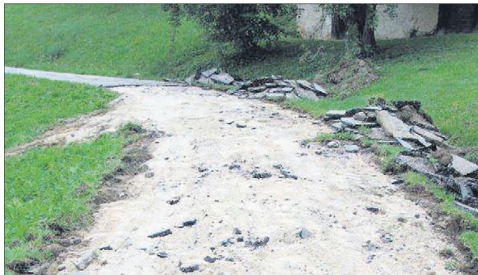
Pogled na »razrito« cesto po ponedeljkovem večernem obračunu v Lipi pri Frankolovem
