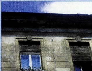
Vrh stavbe, od koder je na tla padel več kilogramov težak betonski del.
