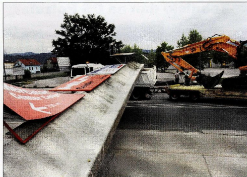
Betonski stebel je padel na tovornjak, ki je s kopačem trčil vanj.
