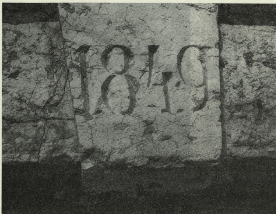
Sl. 4. Portal vrat na zahodnem delu dvorišča je iz okrasnega apnenca. Medtem ko je odprta površina na južni strani korodirana, vendar izprana in čista, se je na spodnji strani preklade začela nabirati črna skorja sadre in saj z veliko količino SO_2 (42,1 %)
