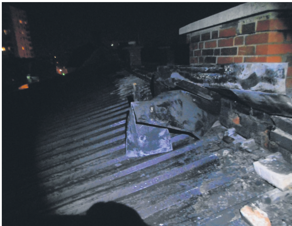
Dimniškega požara ne smemo nikoli gasiti z vodo, ker se voda v dimniku upari in lahko poškoduje tako tistega, ki gasi, kot dimnik.
