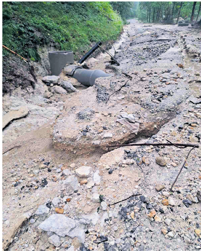
V Mozirju je deževje poškodovalo dva cestna odseka, ki sta bila sicer pripravljena za asfaltiranje. (Foto: Občina Mozirje)
