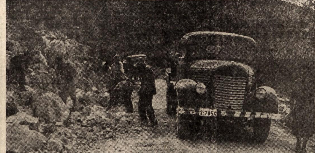
Cesto čez Gorjance razširjajo in modernizirajo; vzdolž delovišč so si odprli tudi več novih kamnolomov in uredili naselje za delavce
