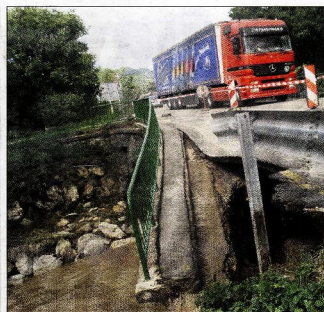
Voda je most načela, promet pa ga je dokončno porušil.
