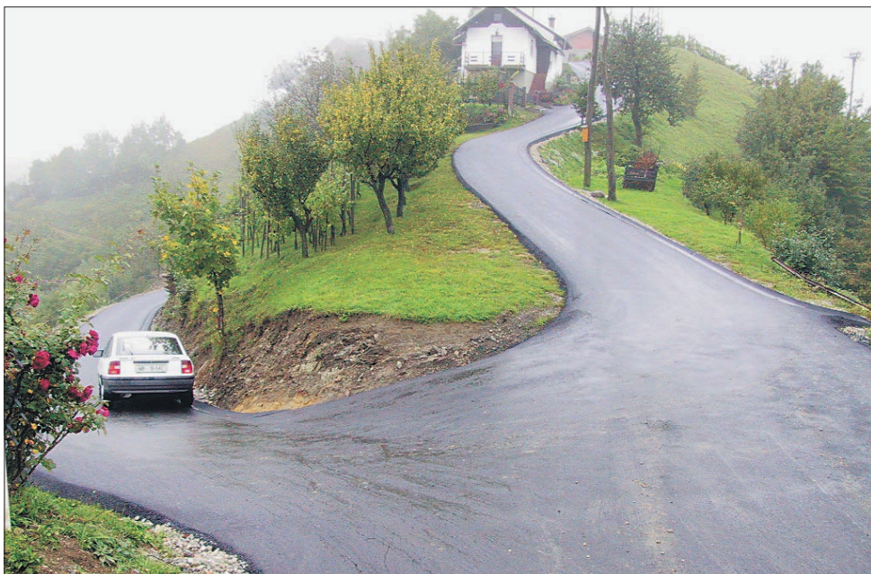
Strma in vijugasta cesta na Mezinec pod še svežo asfaltno prevleko
