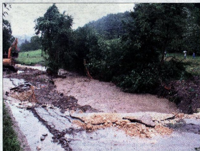
Voda je v Pongracu odnesla 100 metrov ceste.
