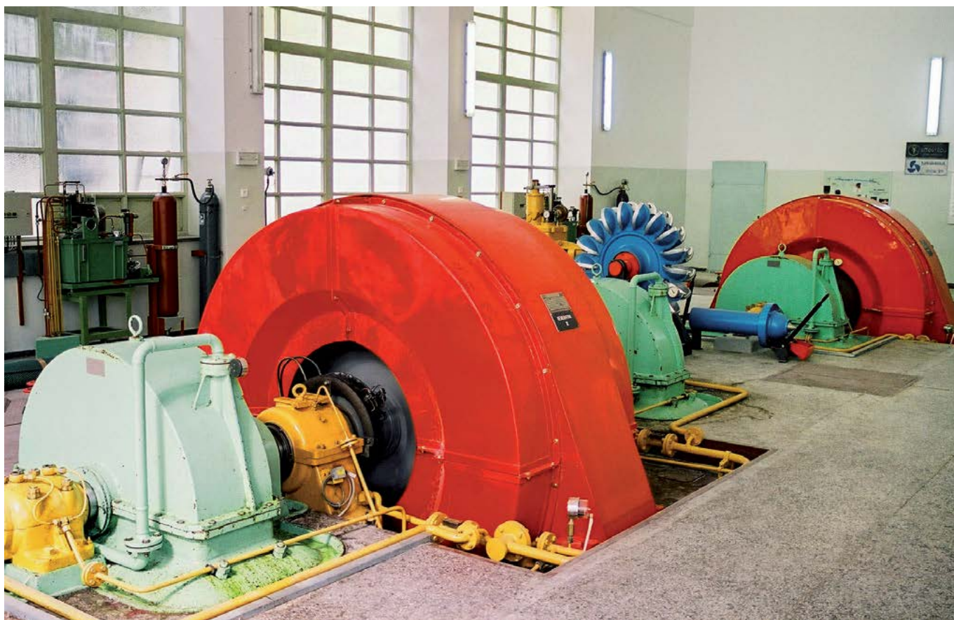
Notranjost hidroelektrarne Savica, zgrajene leta 1949
