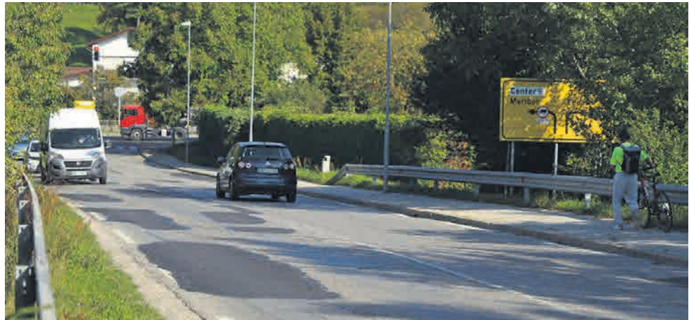
»Kot da bi se otroci igrali,« je bilo po krpanju odseka Dornavske ceste slišati v mestu. Na republiški Direkciji za infrastrukturo so navedli, da so ročno pokrpali udarne jame in razpoke.
