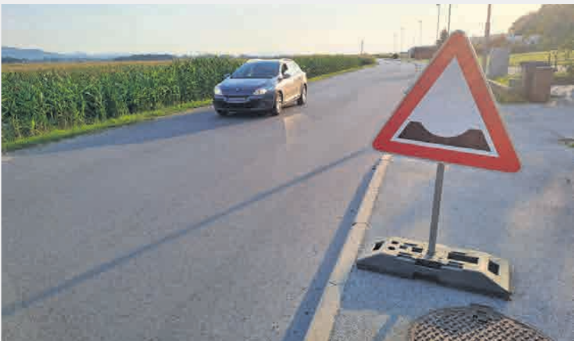
Tudi prometni znak opozarja na poškodovano cestišče. Eden je postavljen kar na sredino pločnika.
