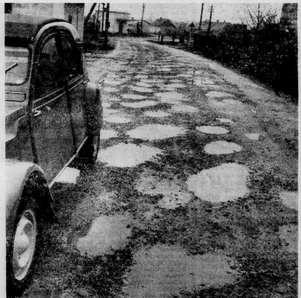
Da je Vodovodna cesta v Ljubljani v takem stanju, je temu brzokone vzrok le malomarnost. Ob cesti je dovolj gramoza, ki bi ga cestar lahko uporabil vsaj za najnujnejša popravila. Foto: Z. Deniša
