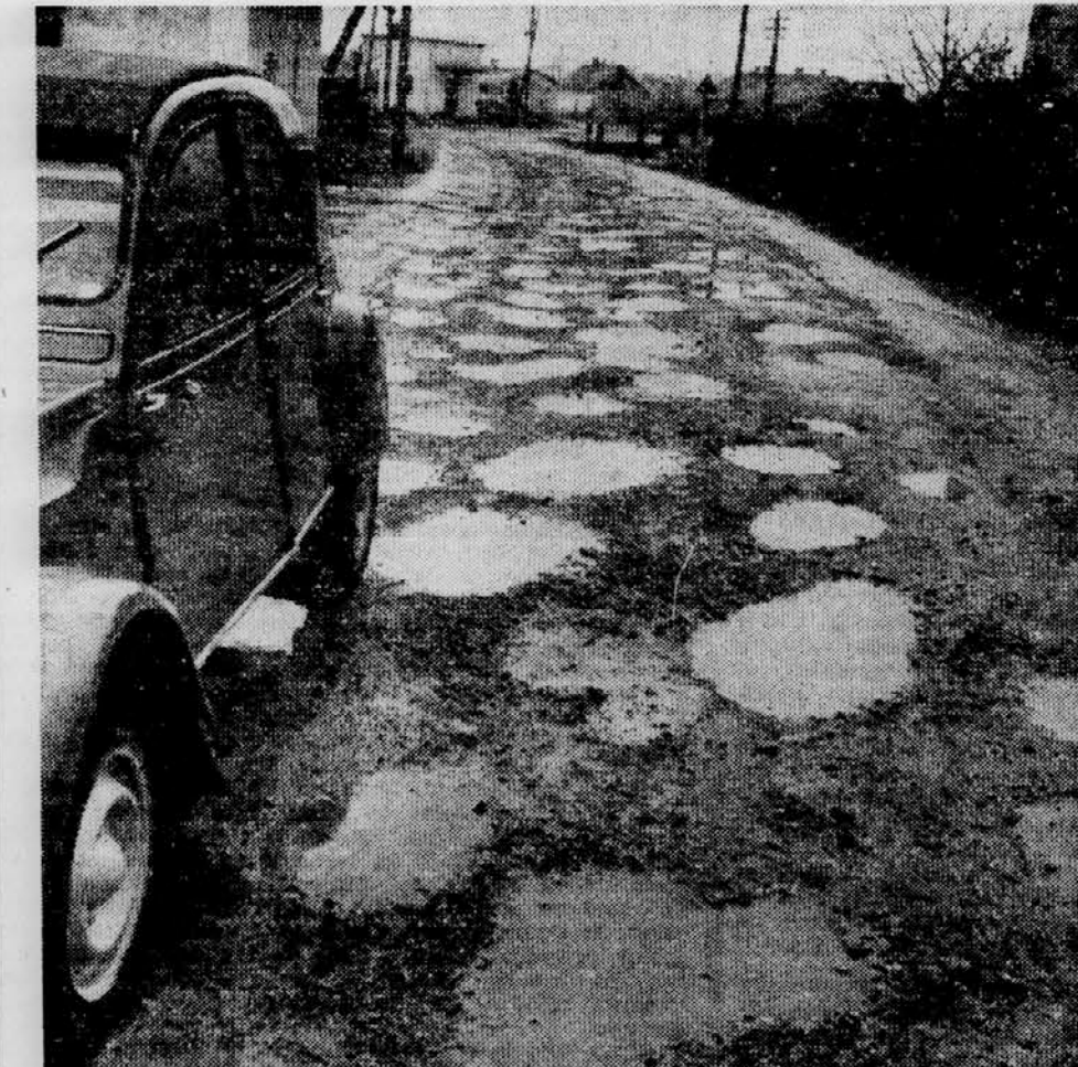
Da je Vodovodna cesta v Ljubljani v takem stanju, je temu bržkone vzrok le malomarnost. Ob cesti je dovolj gramoza, ki bi ga cestar lahko uporabil vsaj za najnujnejša popravila. Foto: Z. Deniša
