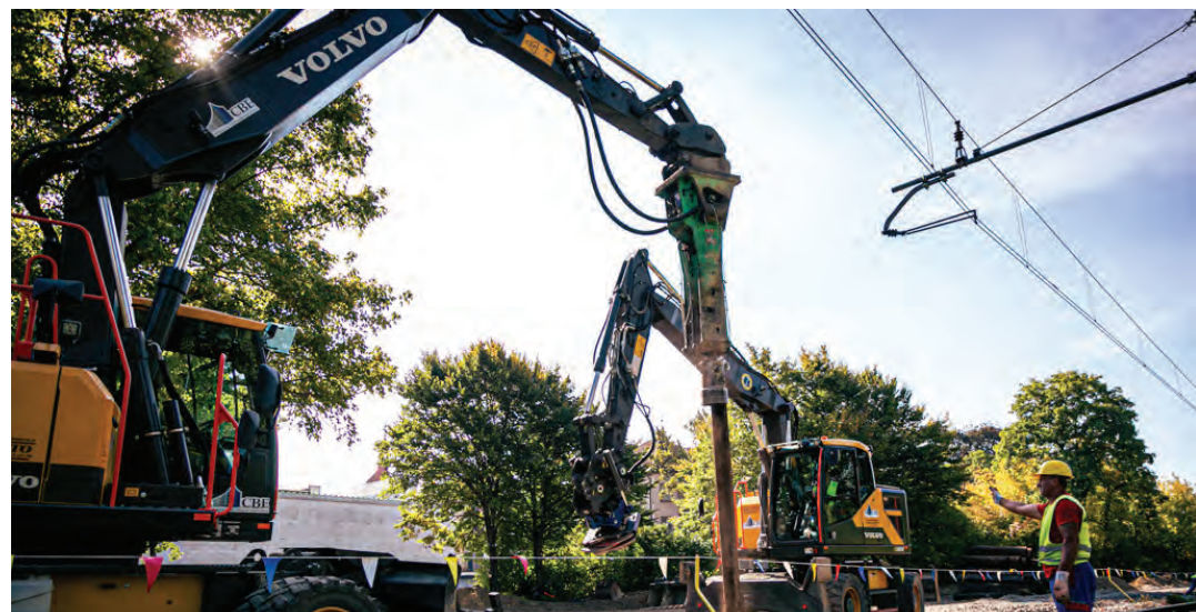
Septembra in oktobra so dela opravljali na levem tiru, prvenstveno pri prenovi tirnih naprav ter sanaciji podvozov in mostov.
