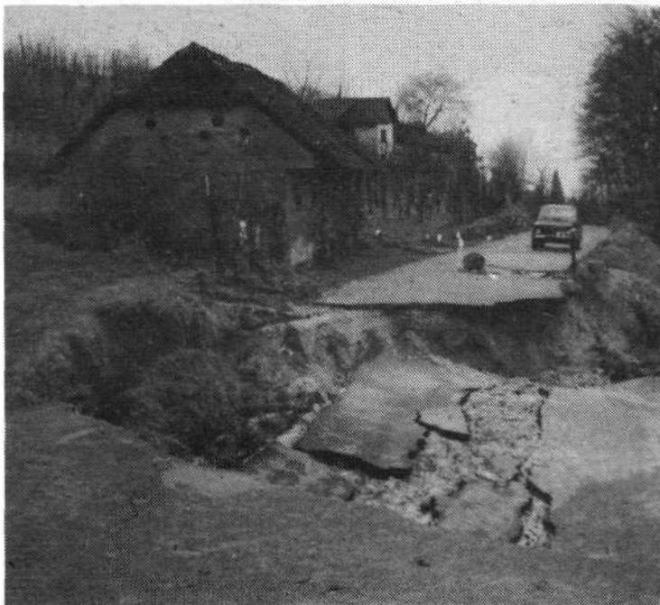
Plaz je odtrgal cesto na Kremen na mestu, ki je bilo znano kot plazovito. To je za krajanje Lok, Kremena in Bučerce pomenilo 6 km daljšo pot preko Zdol do Krškega. Nujna sanacija, ki bo zagotovila prevoznost, se je tu začela pretekli teden in je zdaj že pri koncu.
