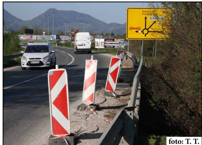
Most je potreben obnove.
