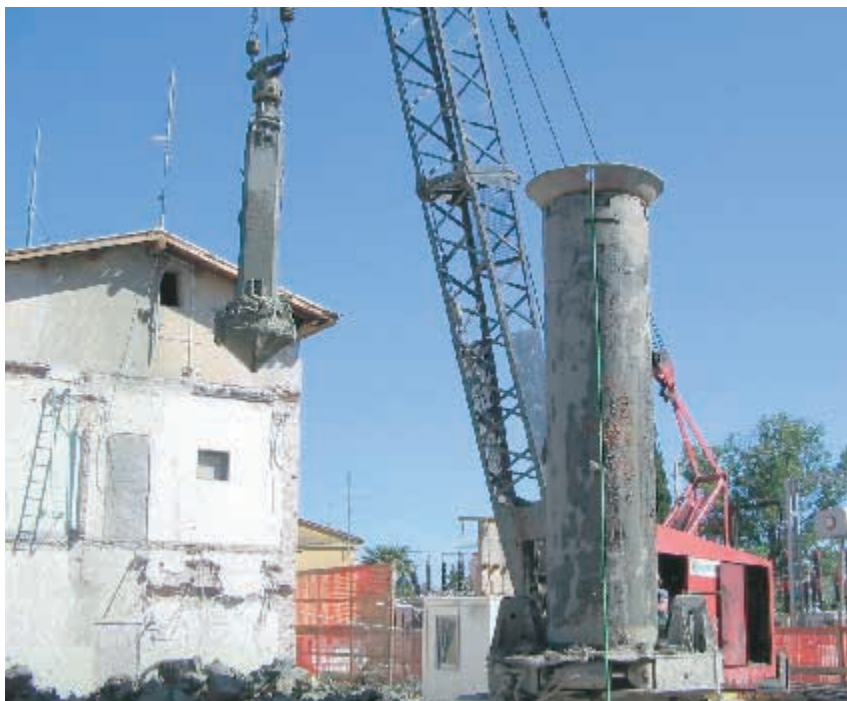
Pred začetkom temeljenja so morali položiti 36 pilotov s premerom sto centimetrov v globino 16 metrov.
