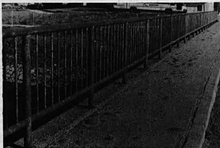
Rjasta ograja, uničen asfalt in zanemarjeno cestišče nam ni v čast
