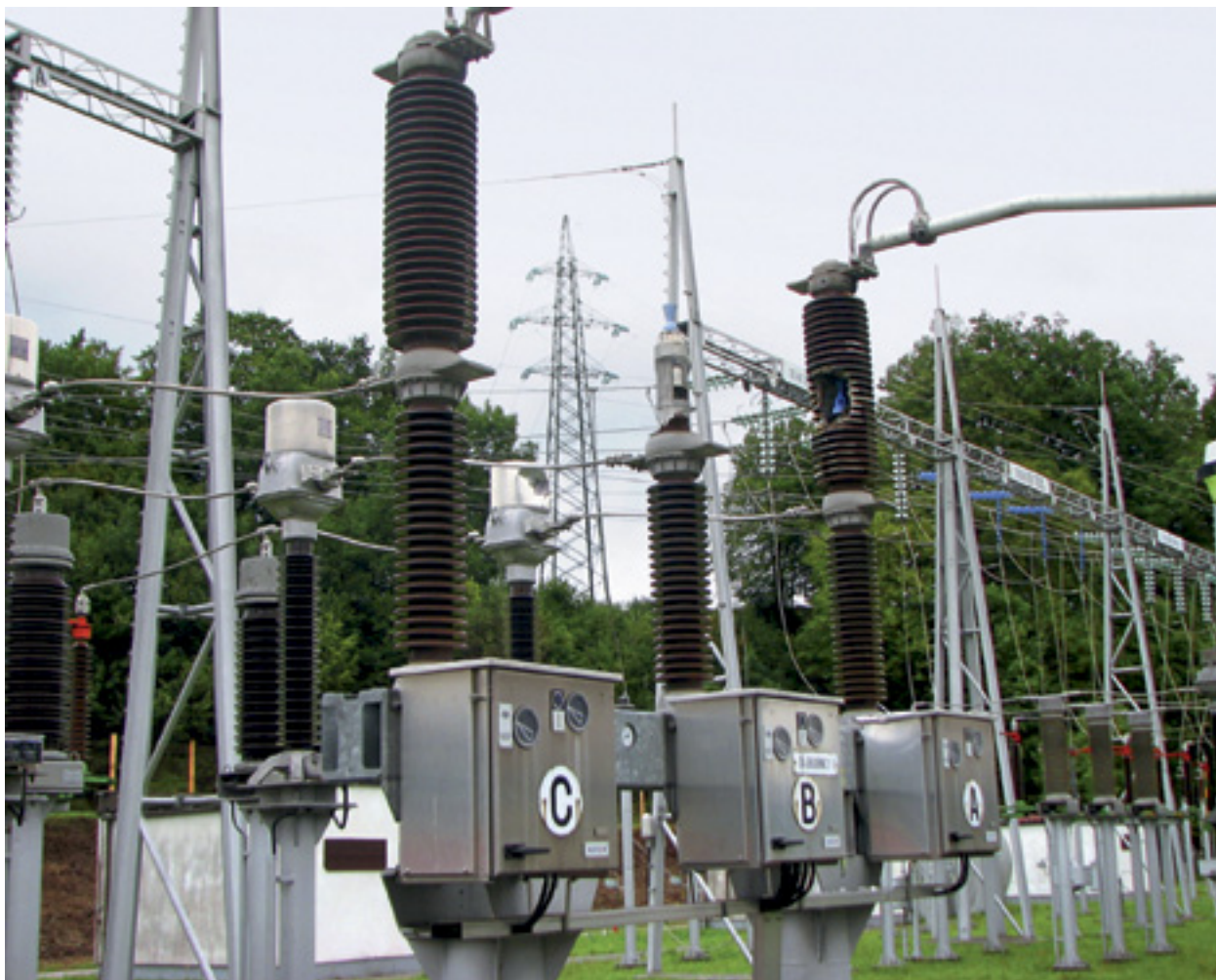
Poškodba visokonapetostnega odklopnika po eksploziji prekinjevalne komore.
