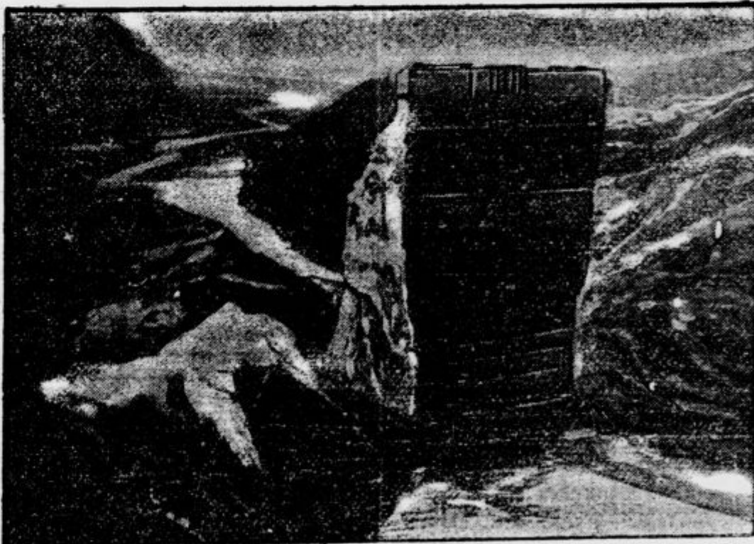
Dolinska pregrada, ki jo je porušil pritisk vode ob lanski pomladni poplavi
