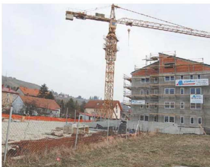
Na gradbišču lendavskega Stavbarja ni žive duše. Zaradi neporavnanih računov je štiriindvajset stanovanj še vedno nedokončanih.
