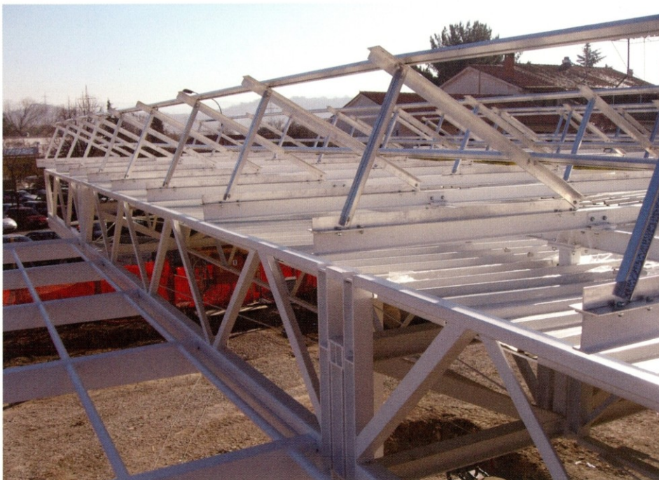
Montažna konstrukcija za solarne panele na nadstrešnici
