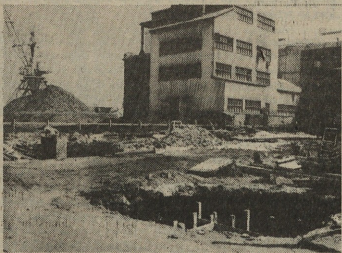
Dela na deponiji premoga v puljski cementarni.
