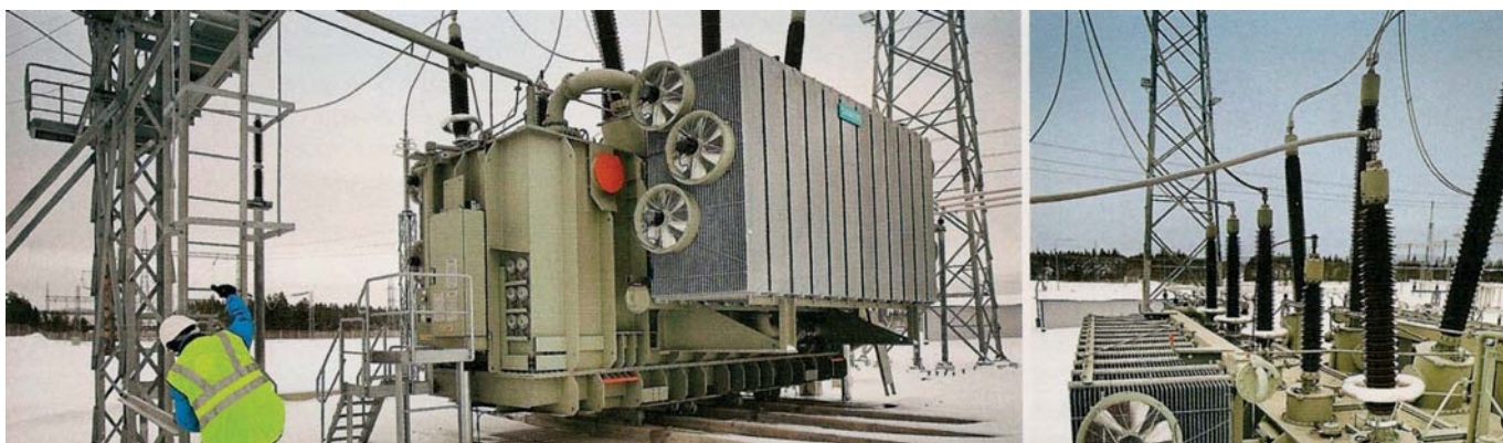
Prilagojeni za vsako vreme: sodobni transformatorji lahko delujejo tudi pri -50^{\circ}\text{C} , bočni ventilatorji pa onemogočajo nabiranje snega in leda.
