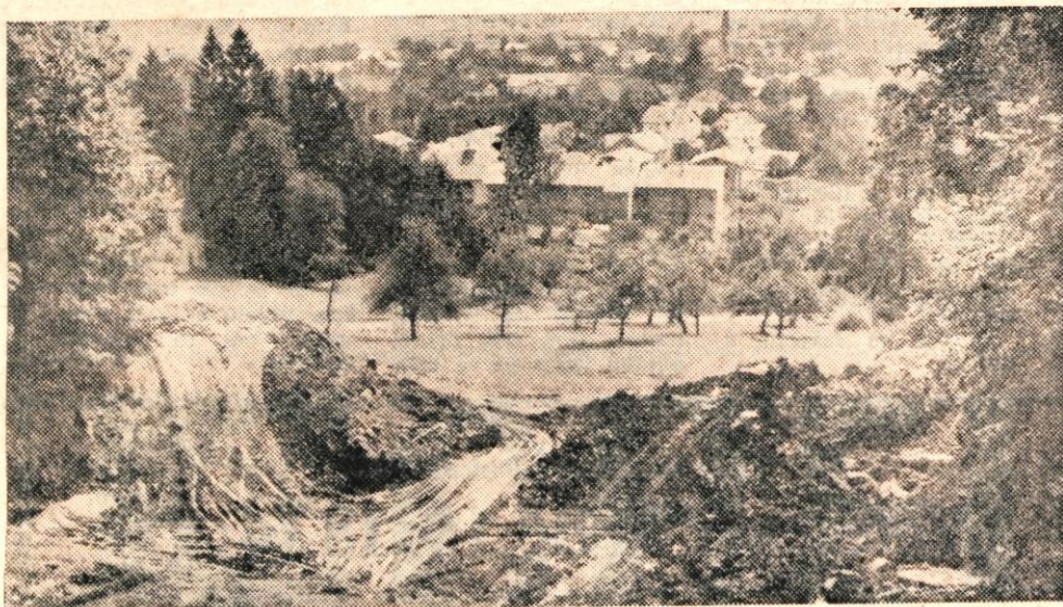
Podjetje Megrad iz Ljubljane gradi v Stražišču pri Kranju akumulacijski vodovodni rezervoar, ki naj bi v poletnih konicah preprečil pomanjkanje pitne vode v Kranju in Stražišču. Prostornina rezervoarja bo znašala 1050 kubičnih metrov, dograjen pa bo maja prihodnjega leta. Investitor za izgradnjo tega rezervoarja je komunalno podjetje Vodovod Kranj in bo po predračunih veljal okrog 45 milijonov starih dinarjev. Novi rezervoar bo hkrati pomenil tudi osnovo za začetek gradnje vodovoda Stražišče—Zabnica. (A. Z.) — Foto: F. Perdan
