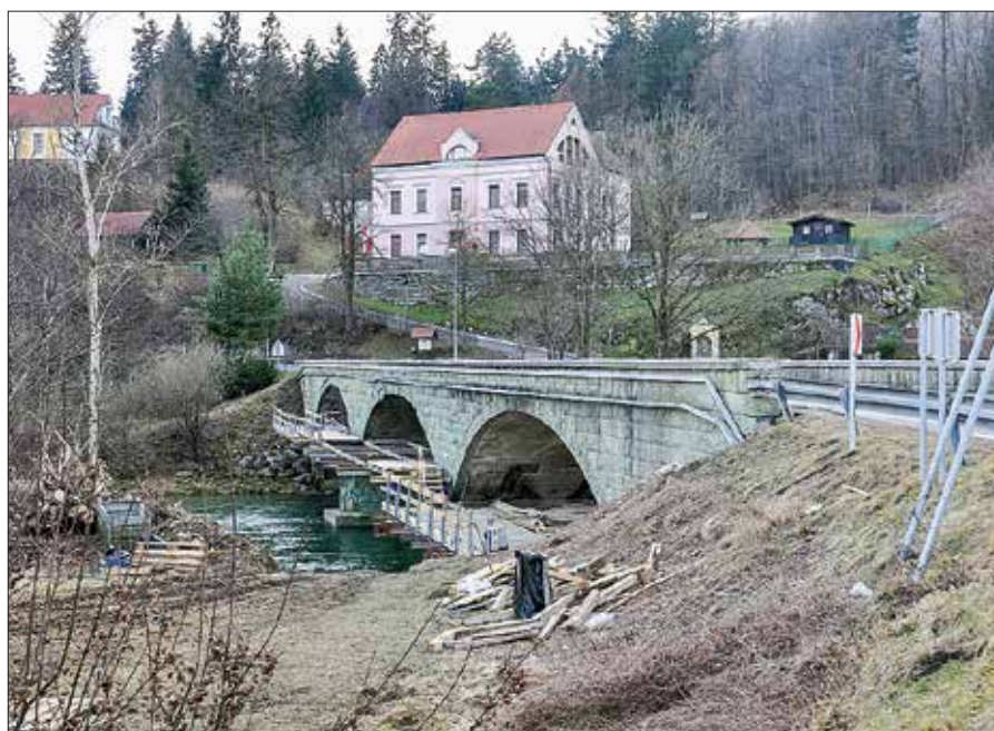
Prepotrebna obnova mostu v Letušu že poteka, v nadaljevanju je predviden izmeničen enosmerni promet.
