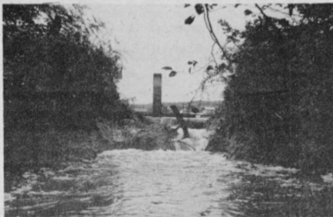
Nasip ob ribniku v Velovlaku je popustil pod silnim pritiskom vode, ki je rušila vse pred seboj
