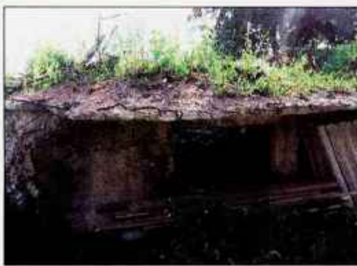
Podrti črni gradnji sta vidni še danes in zaraščeni s travo in drevjem. (Foto: Maja Bertoncelj)
