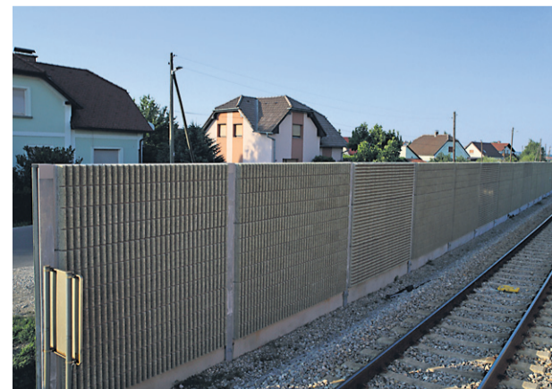
Meritve so pokazale, da protihrupne ograje ob železniški progi Pragersko-Hodoš zadostujejo kriterijem: na vseh ograjah pri prehodu skozi konstrukcije je namreč hrup zmanjšan za najmanj 25 dB.
