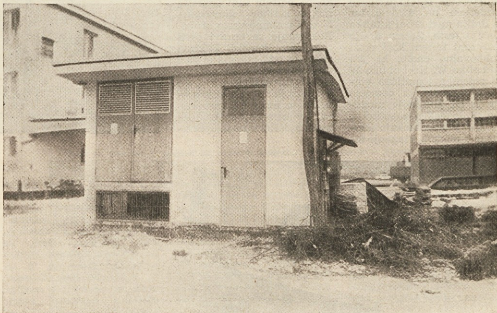
Transformatorska postaja kombinata, ki stoji ob koncu pekarnice na Šmartinski cesti
