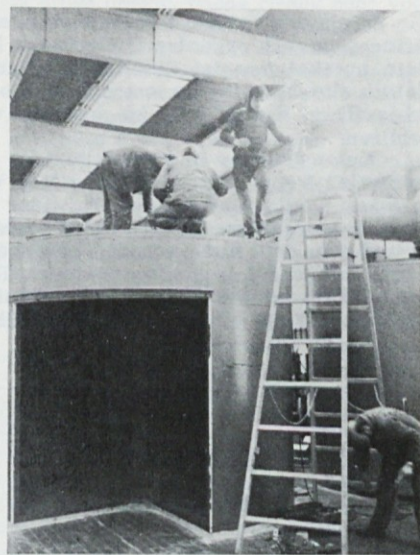
Montaža še enega »MOHR« sušilnega stroja
