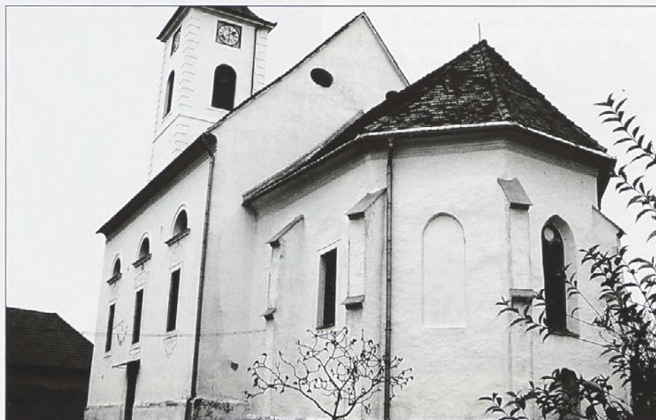
Ostrešje na farni cerkvi sv. Miklavža je v zelo slabem stanju, zato so se v župniji odločili za temeljito prenovo in pripravljala dela so že v teku
