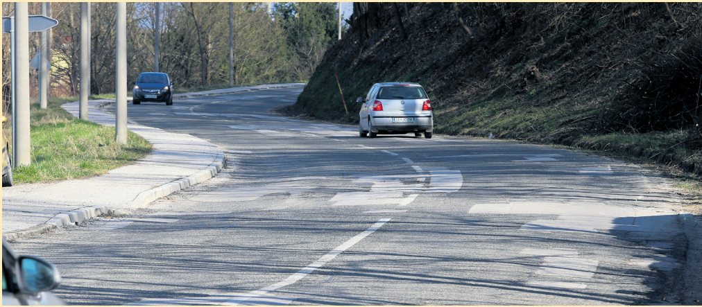
Primer, kjer naj bi kar nekaj let imeli težave z dogovori s krajinami, naj bi bila Teharska cesta v Celju. Del ceste je zdaj že obnovljen, zadnji del ceste v smeri Teharja pa še vedno predstavlja izrazito nevaren odsek, a po neuradnih podatkih naj bi bil razlog za to, da cesta še ni povsem obnovljena, tudi v pridobivanju zemljišč. Čas v takšnih primerih mineva in vsak dan obstaja nova nevarnost, da se na takšnih odsekih zgodi tragedija. (Foto: Andraž Purg)
