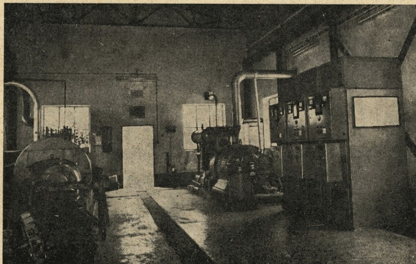
Notranjost kompresorske postaje na Neži v Trbovljah.
