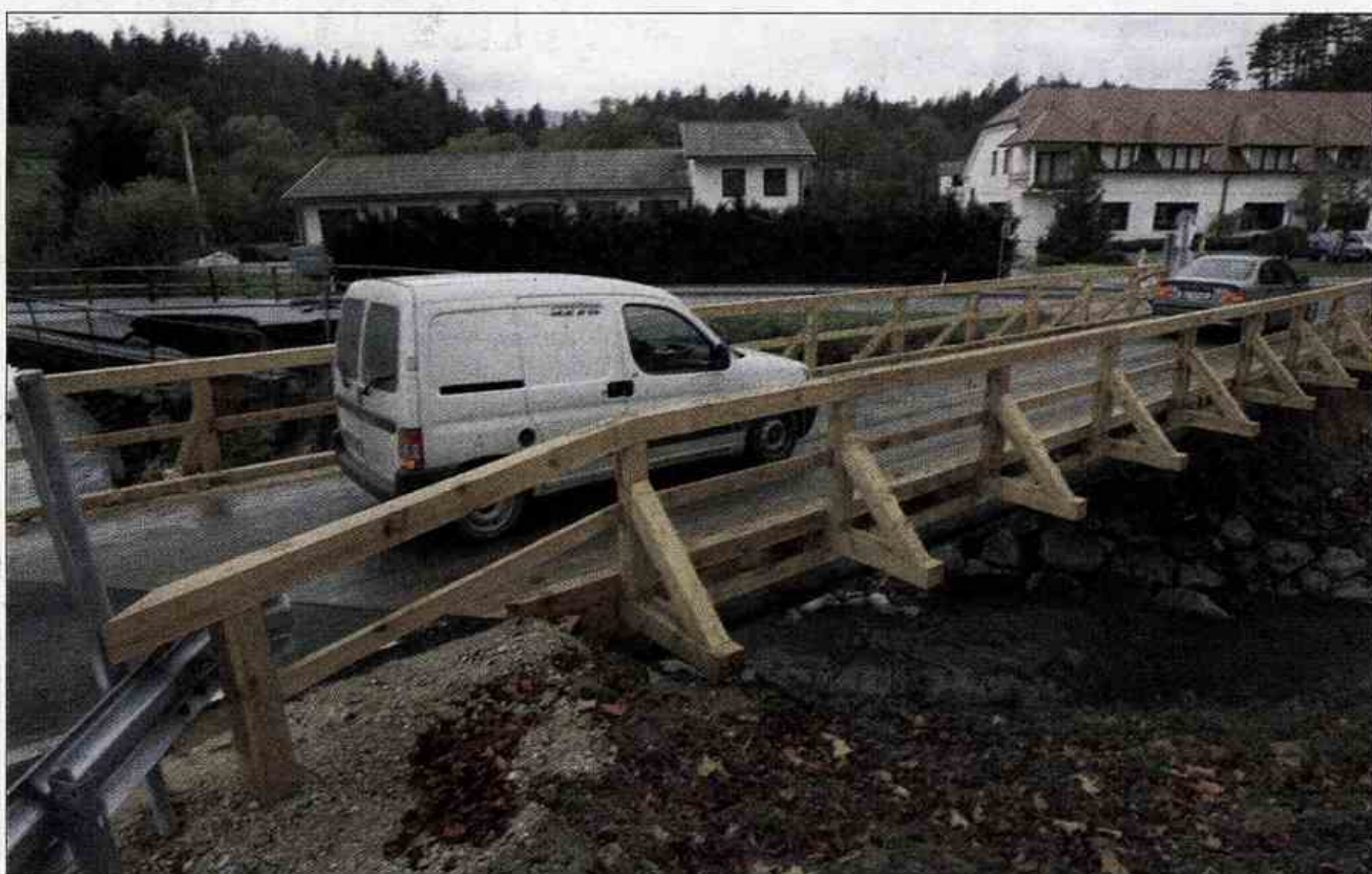
Septembrska ujma je most tako uničila, da so morali postaviti zasilnega. Nov bo sicer boljši, vendar bo nanj treba še dolgo čakati.
