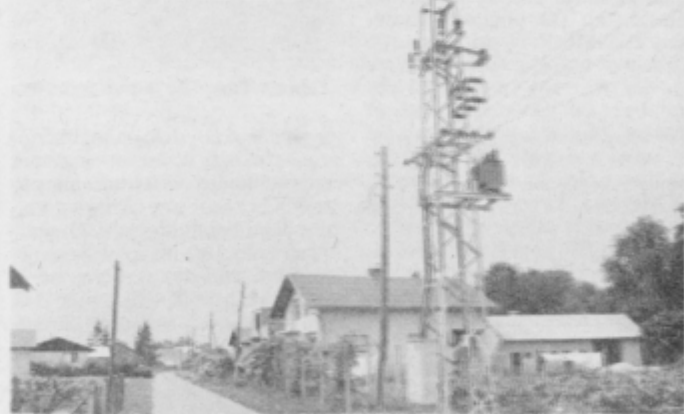
Nova trafo postaja bo kmalu priključena v omrežje
