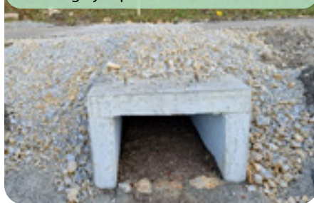
Vgrajen podhod za dvoživke
