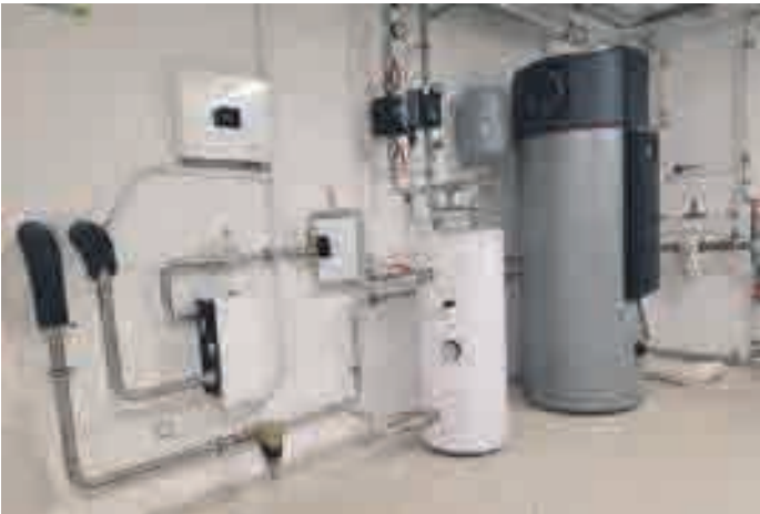
Kotlovnica z vso naj sodobnejšo opremo.
