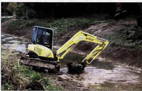
Nujno urejenje vodotokov po nedavnih poplavah. (Foto: GK)
