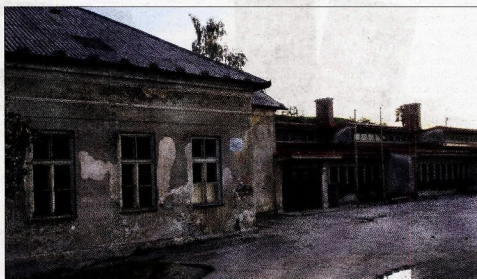
Šola v Šentrupertu je v katastrfalnem stanju. V letu 2009 naj bi končno zgradili novo.
